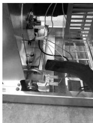
Fig. 74 - Nettoyage de le ventilateur ambiant
