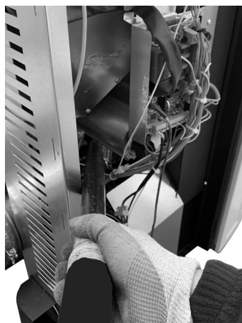
Fig. 86 - Nettoyage de le ventilateur ambiant
