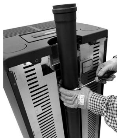
Fig. 62 - Conduit arrière d'évacuation des fumées monté
